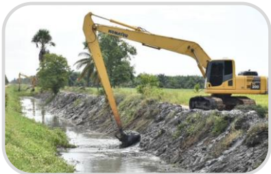
ดูแล ระบบระบายน้ำ
